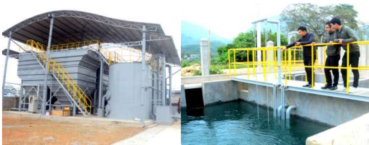
Hình: Trạm xử lý nước mặt 5.000 m 3 /ngày phường Minh Xuân
