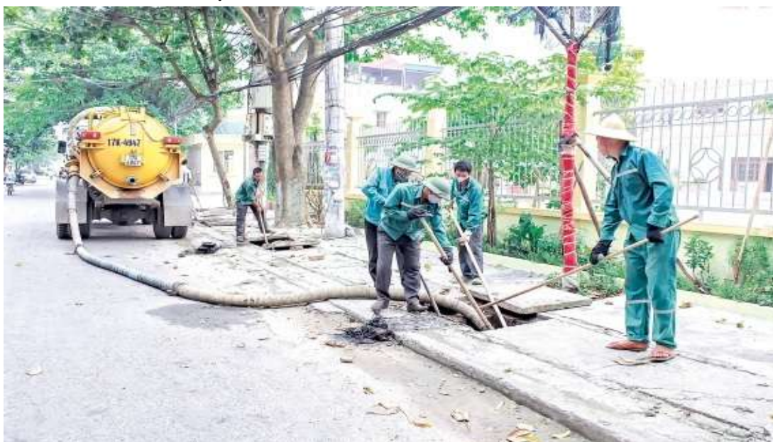
Hình: Công thoát nước trên địa bàn thành phố
